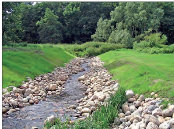
Rückbau eines Sohlabsturzes an der Schwartau und Bau einer Sohlgleite (Foto: WBV OH)
